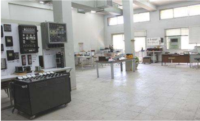
شکل ۵- آزمایشگاه رله و حفاظت الکتریکی
